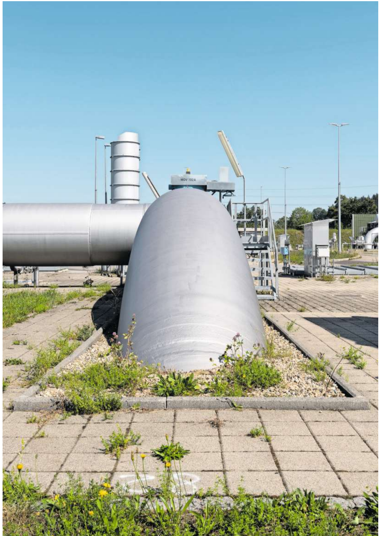
Nach Hunderten Kilometern unter der Erde kommen die Stränge der Transitzgas-Pipeline in Ruswil an die Oberfläche.
